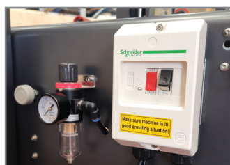
INTERRUTTORE GENERALE MAIN POWER SWITCH
