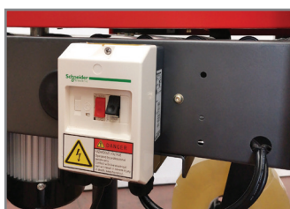
INTERRUTTORE GENERALE MAIN POWER SWITCH
