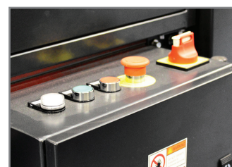
PANNELLO DI CONTROLLO CONTROL PANEL
