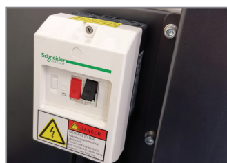
INTERRUTTORE GENERALE MAIN POWER SWITCH
