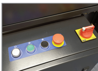
PANNELLO DI CONTROLLO CONTROL PANEL
