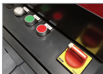
PANNELLO DI CONTROLLO CONTROL PANEL
